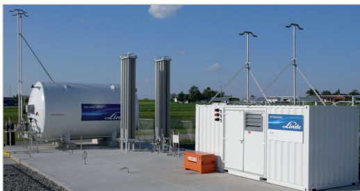
Abb. 2-5: Flüssigspeicherung von Wasserstoff [Quelle: LindeGas]
